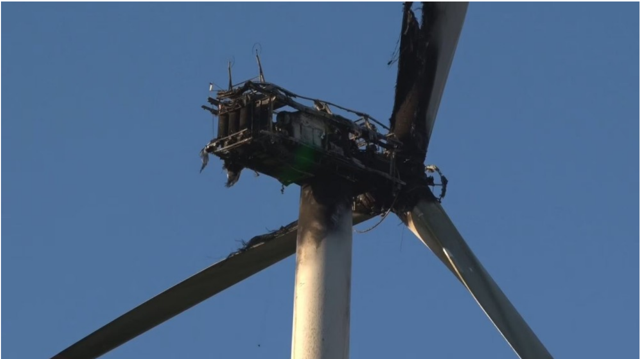
Das ausgebrannte Windrad in Gildehaus. (Archivbild)
